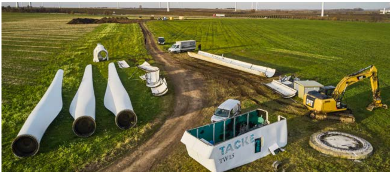
Rückbau einer Windkraftanlage vom Typ Tacke TW 1.5s aus dem Jahr 1999 im Windpark Sitten in Sachsen
