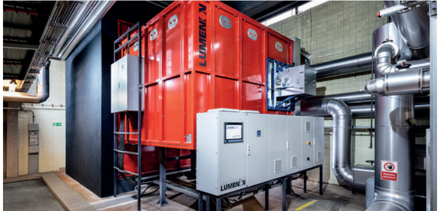
In eine Heizzentrale eines großen Wohnkomplexes in Berlin integrierte Speicheranlage von Lumenion
