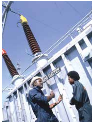
Elektrizitätswerk in Sambia.
