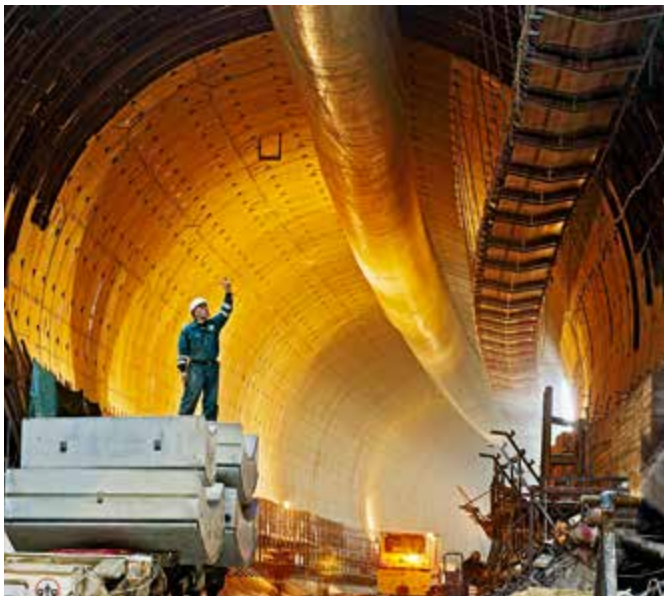
Aus Baden-Württemberg in die Welt: Herrenknecht entsendet seine Mitarbeiter weltweit, hier zum Beispiel nach Madrid, wo die Tunnelvortriebsmaschinen des Mittelständlers zum Einsatz kommen.
